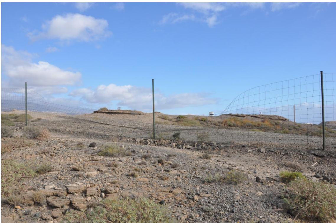
Figura 6. Valla perimetral rota
