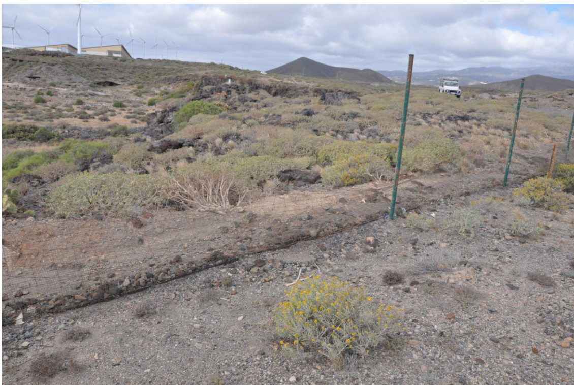
Figura 1. Valla perimetral rota
