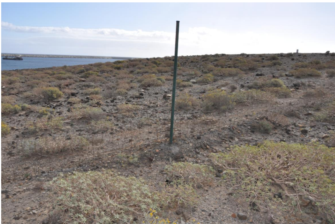
Figura 4. Valla perimetral rota
