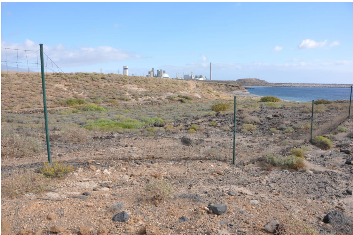
Figura 5. Valla perimetral rota
